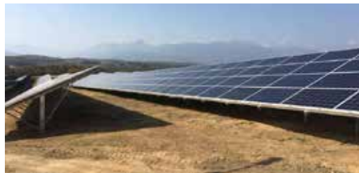
Fig. 4 Panelet solare të "Eko Parkut" në Gjakovë
